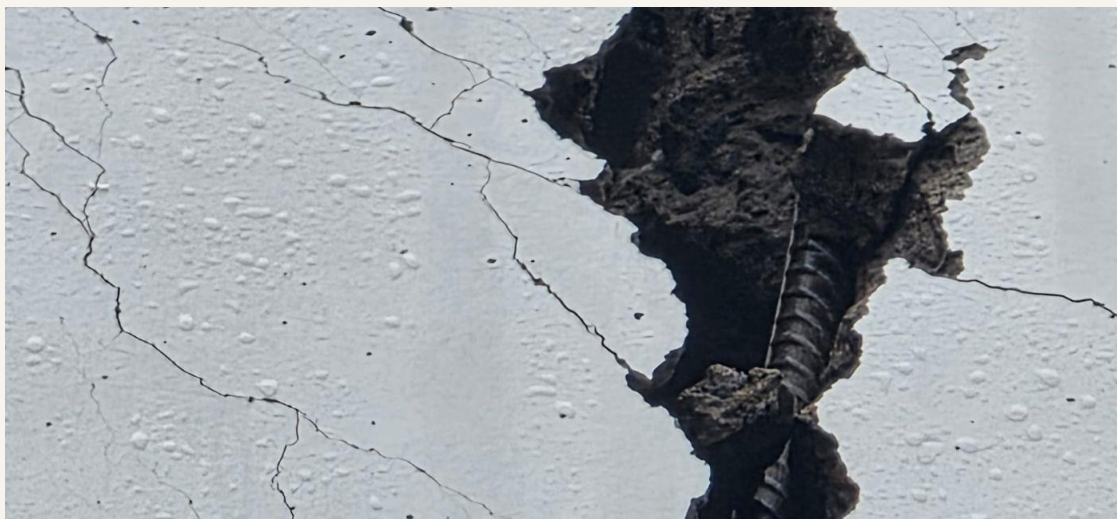
Fotografia 91 — Cabeça de pilar com o cobrimento destacado ao longo de uma barra, exposta em toda a altura visível, e fissuras ramificadas em volta.
