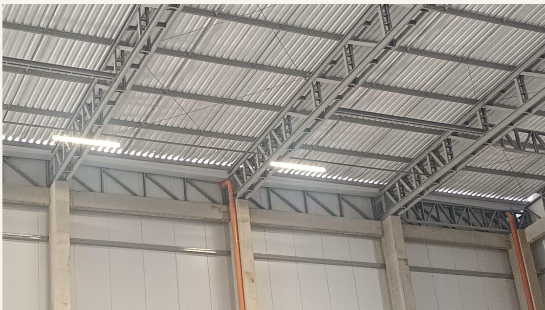
Fotografia 66 — Mesma parede lateral, outro trecho: tesouras chegando ao topo dos pilares e ondas da telha abertas na borda.
