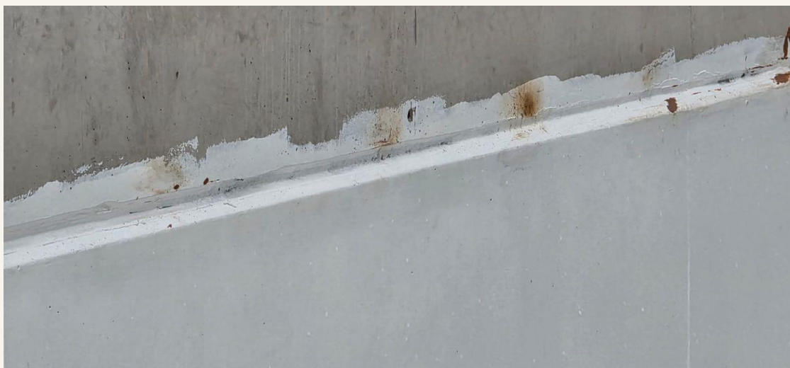
Fotografia 31 — Outro trecho da mesma linha de fixação arrancada.
