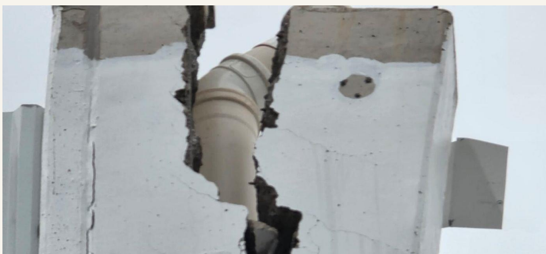
Fotografia 27 — Cabeça de pilar partida de alto a baixo, com o condutor pluvial atravessando a abertura.
