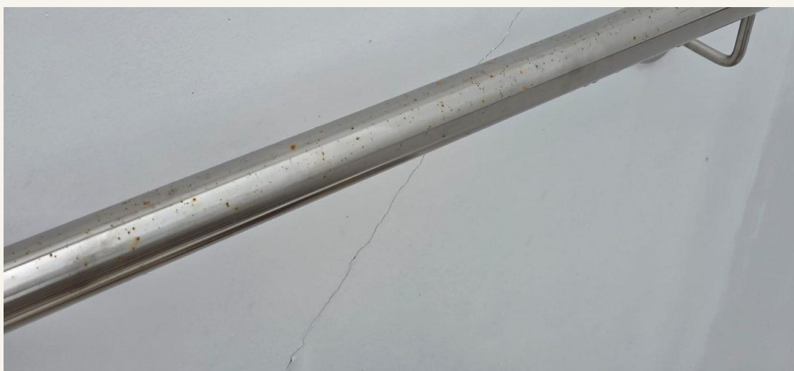
Fotografia 55 — Corrimão da escada interna, com fissura fina na superfície atrás.
