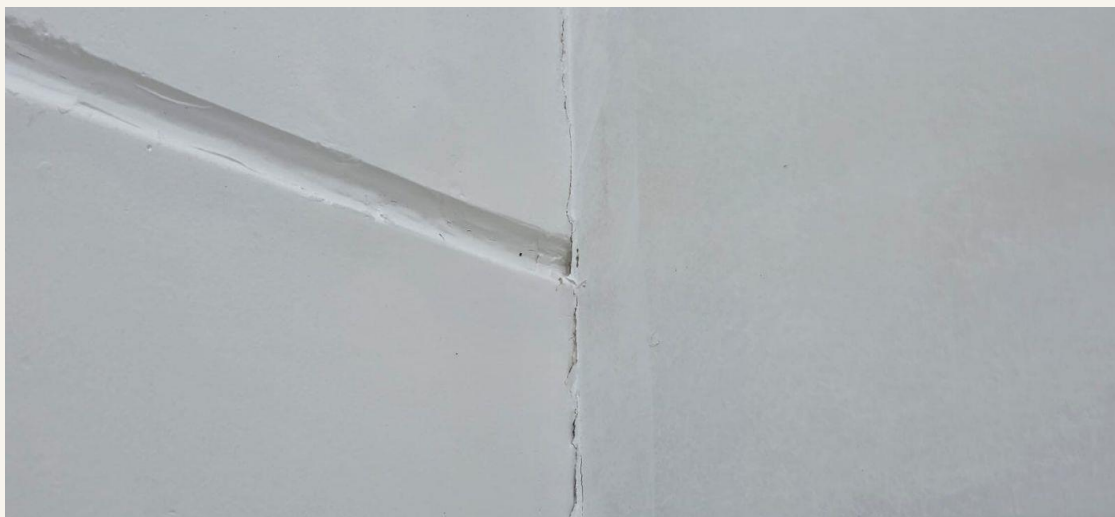
Fotografia 54 — Fissura em canto interno, junto ao cordão de selante.
