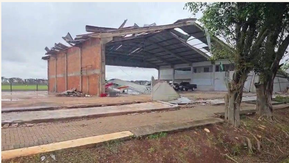
Fotografia 57 — Hangar vizinho, de alvenaria de tijolo cerâmico, com o telhamento integralmente removido. Quadro extraído de vídeo recebido em 11/10/2026.
