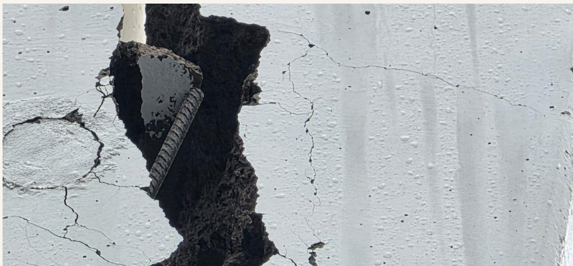
Fotografia 95 — Mesmo pilar: fragmento de concreto com barra, solto na abertura, marca circular à esquerda e fissuras em mapa.
