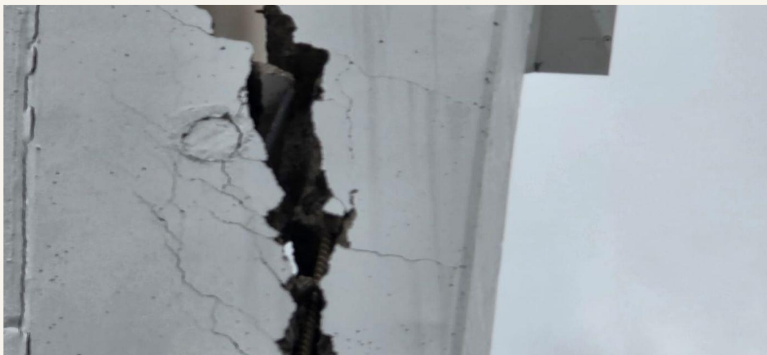
Fotografia 26 — Fenda vertical aberta em elemento de concreto, com armadura exposta no interior.
