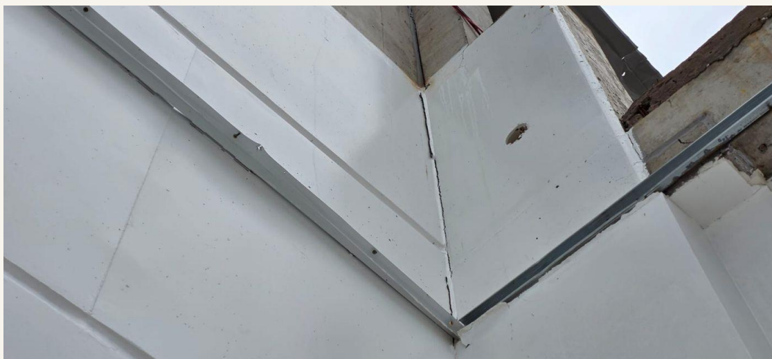
Fotografia 29 — Placa de fechamento perfurada e fissura no encontro entre placas, vista do interior.
