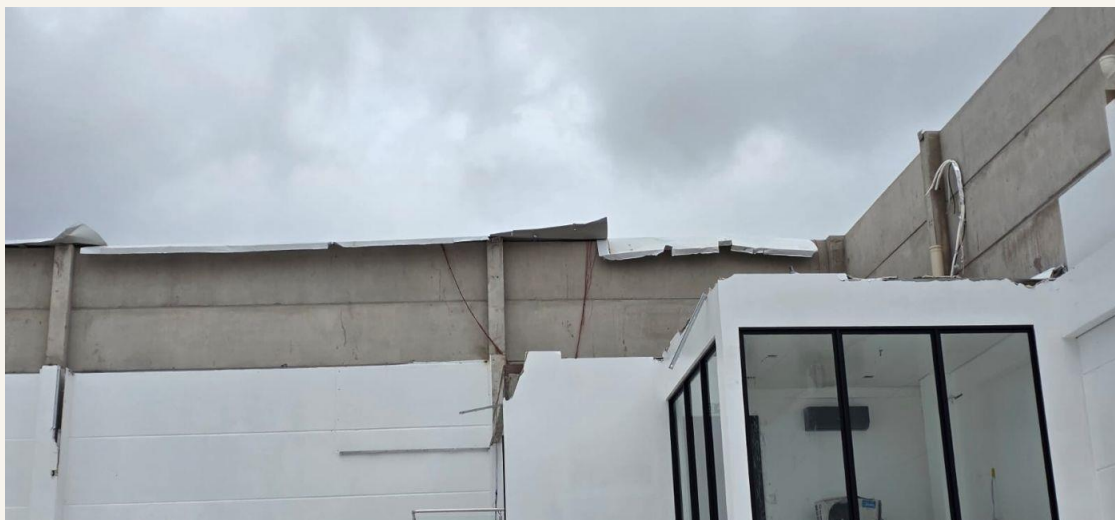
Fotografia 35 — Interior do hangar: viga de concreto aparente, cabos elétricos soltos e céu aberto acima.
