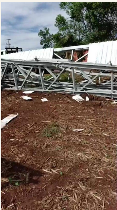
Fotografia 101 — Tesouras deitadas no terreno, deformadas, com retalhos de telha espalhados.
