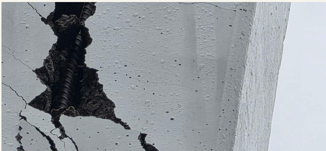
Fotografia 93 — Outra tomada do mesmo pilar: barra nervurada exposta no fundo da abertura e fissura descendo até a borda inferior da imagem.
