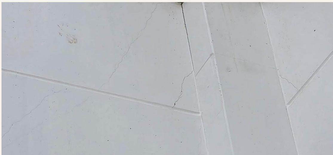
Fotografia 89 — Fissuras finas inclinadas cruzando placas e o encontro com o pilar, com uma junta vertical parcialmente aberta.
