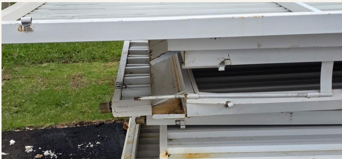
Fotografia 40 — Folha empilhada com a calha-guia deformada e ferragens de rolamento.
