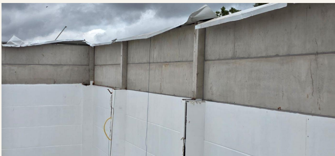
Fotografia 13 — Arremates brancos retorcidos sobre a linha de platibanda, com cabos soltos.
