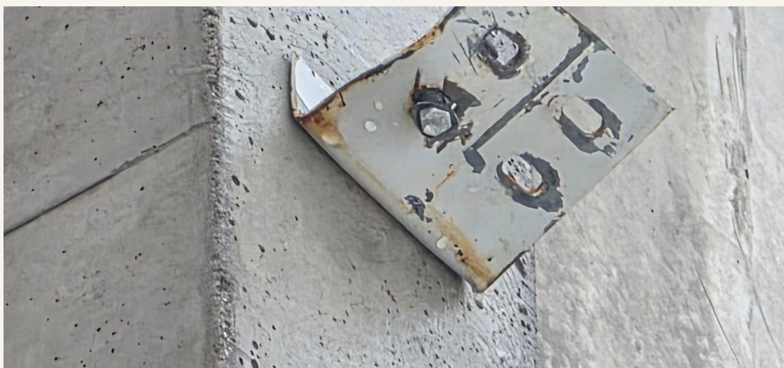
Fotografia 96 — Chapa de ligação no topo de pilar: quatro furos de contorno alongado em dois pares, um único fixador remanescente com porca, e a borda da chapa dobrada para cima.
