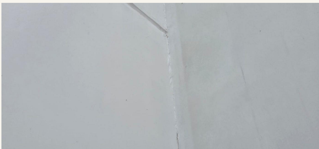
Fotografia 53 — Fissura fina em junta de painel, no interior do bloco de escritórios.
