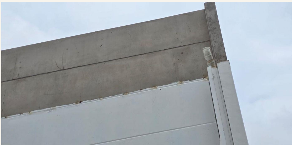
Fotografia 14 — Encontro entre a placa de platibanda em concreto aparente e a placa pintada do fechamento.
