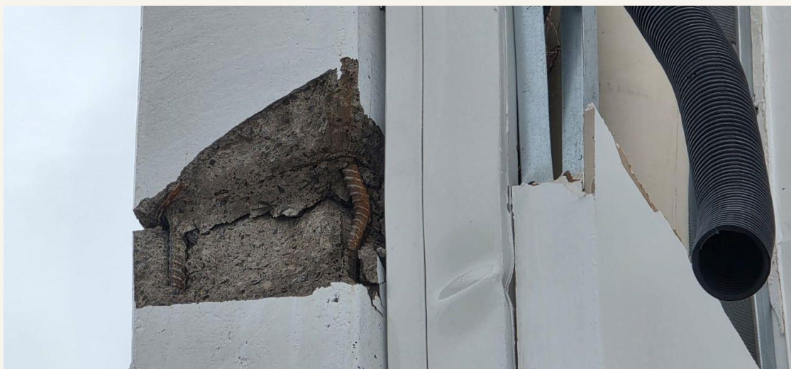
Fotografia 25 — Destacamento do cobrimento em cunha, com armadura longitudinal e estribo expostos.
