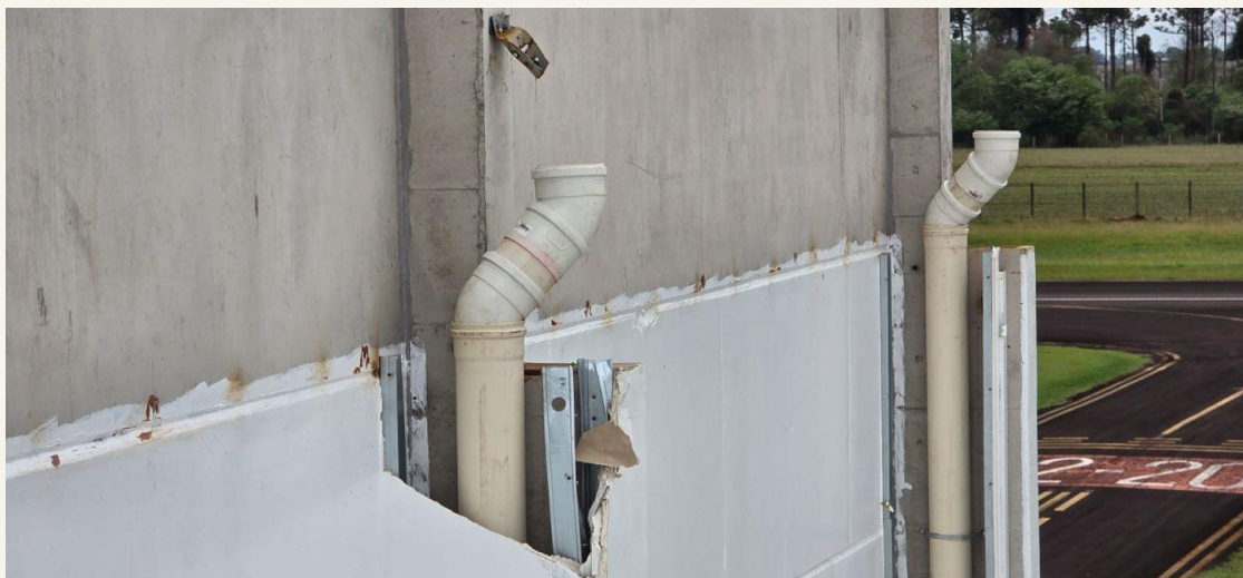
Fotografia 34 — Vista do topo do fechamento com painel rompido e montante galvanizado exposto, e a pista ao fundo.
