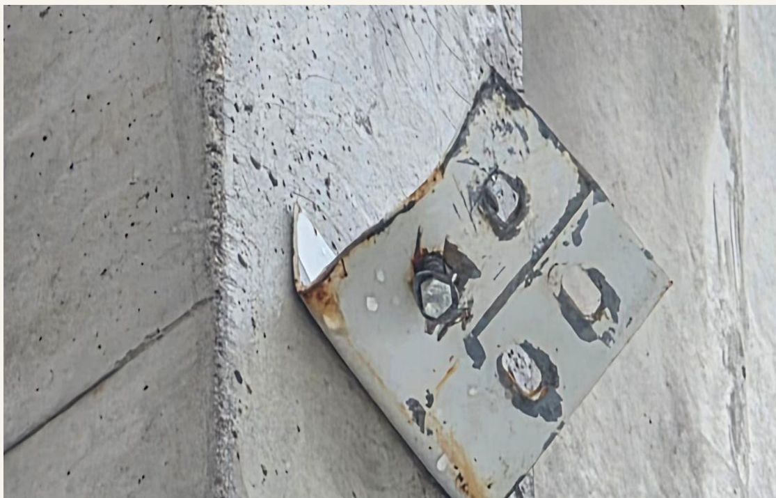
Fotografia 97 — A mesma chapa, em outro enquadramento: linha escura dividindo-a ao meio, furos alongados vazios com marca de oxidação ao redor e o fixador remanescente.
