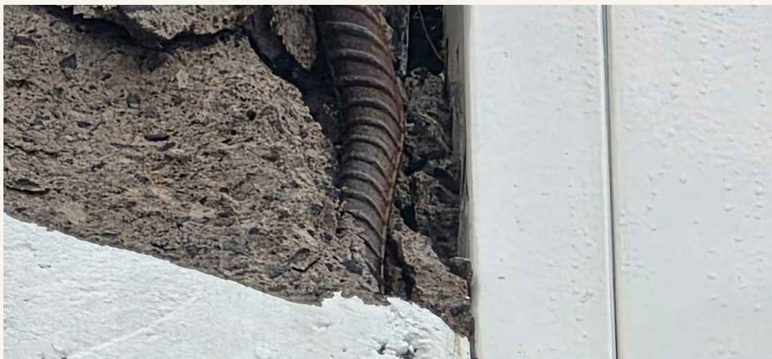
Fotografia 87 — Outra aproximação do mesmo topo: barra nervurada exposta junto à face, com a pintura branca rompida na borda da cunha.
