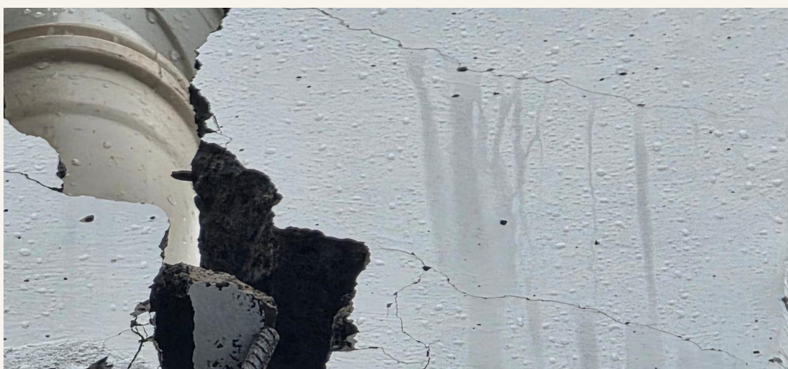
Fotografia 94 — Cabeça de pilar com o condutor pluvial de PVC saindo de dentro do concreto e a fenda aberta junto a ele, com barra exposta.
