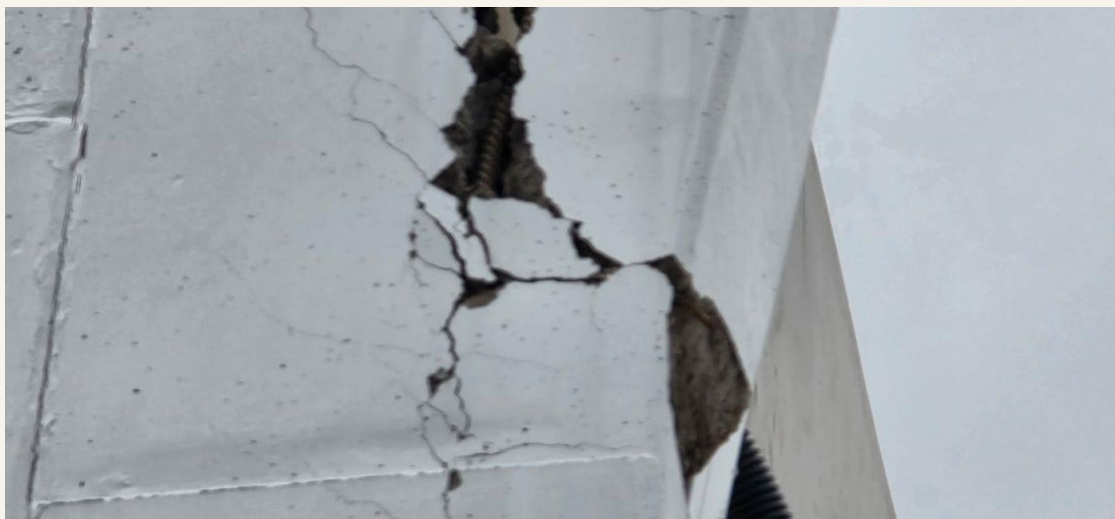
Fotografia 28 — Fissuração em mapa com armadura exposta e fragmento de concreto em destacamento.
