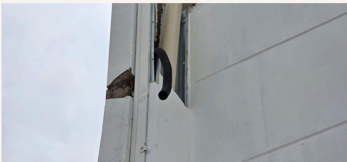
Fotografia 51 — Painel rompido com montante galvanizado exposto e conduíte corrugado.
