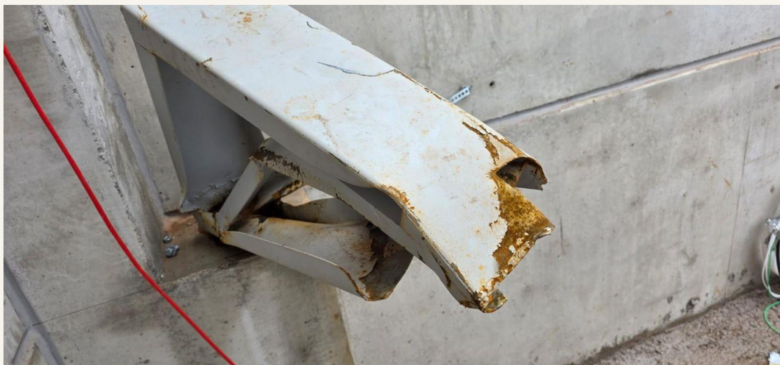
Fotografia 16 — Extremidade de treliça ainda alojada no nicho da placa, com os perfis rompidos.
