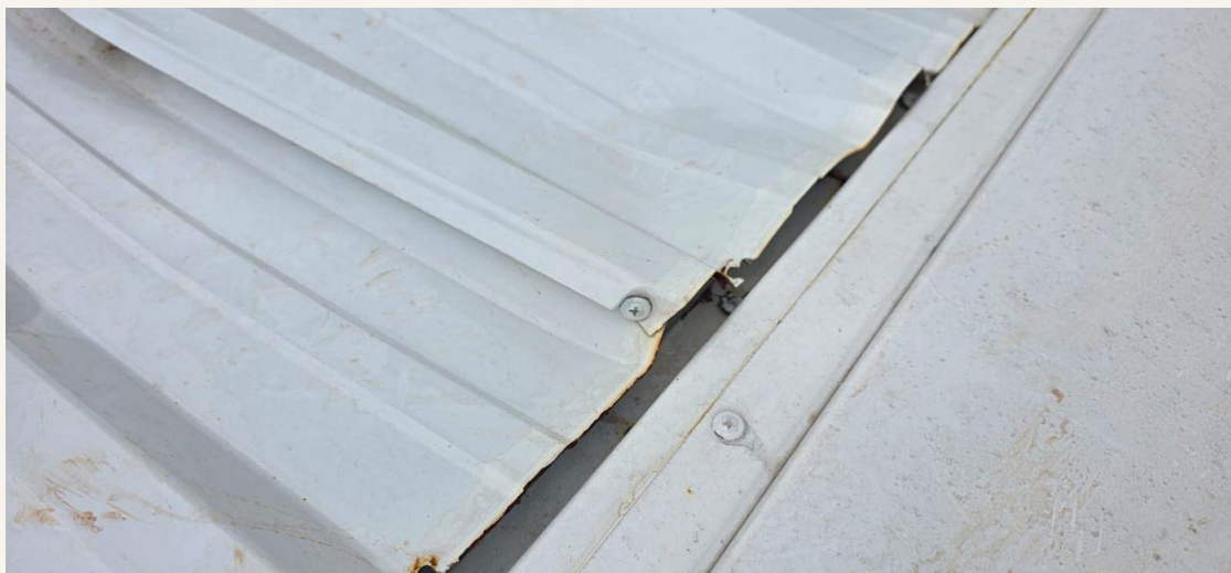
Fotografia 73 — Outro trecho da mesma linha: chapa rasgada junto ao parafuso, com o parafuso ainda fixado na travessa.
