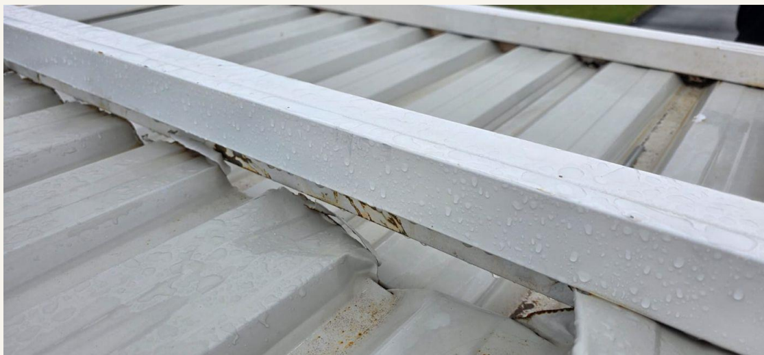
Fotografia 75 — Travessa de folha do portão com a chapa descolada e rasgada por baixo dela, e gotas de chuva sobre a pintura.
