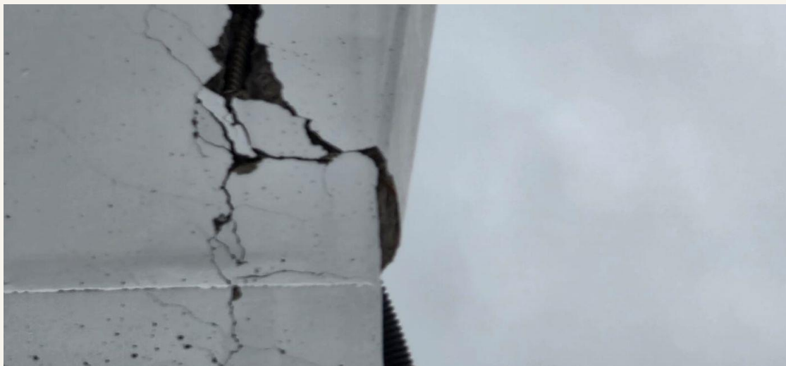
Fotografia 24 — Barra roscaada emergindo de concreto fraturado, com fissuração radial.
