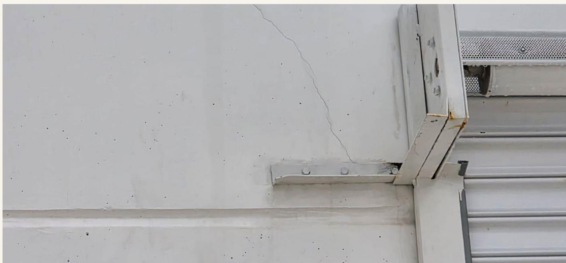
Fotografia 88 — Fissura inclinada na placa de concreto chegando à cantoneira que fixa o batente do portão ao pré-moldado, junto à guia superior.
