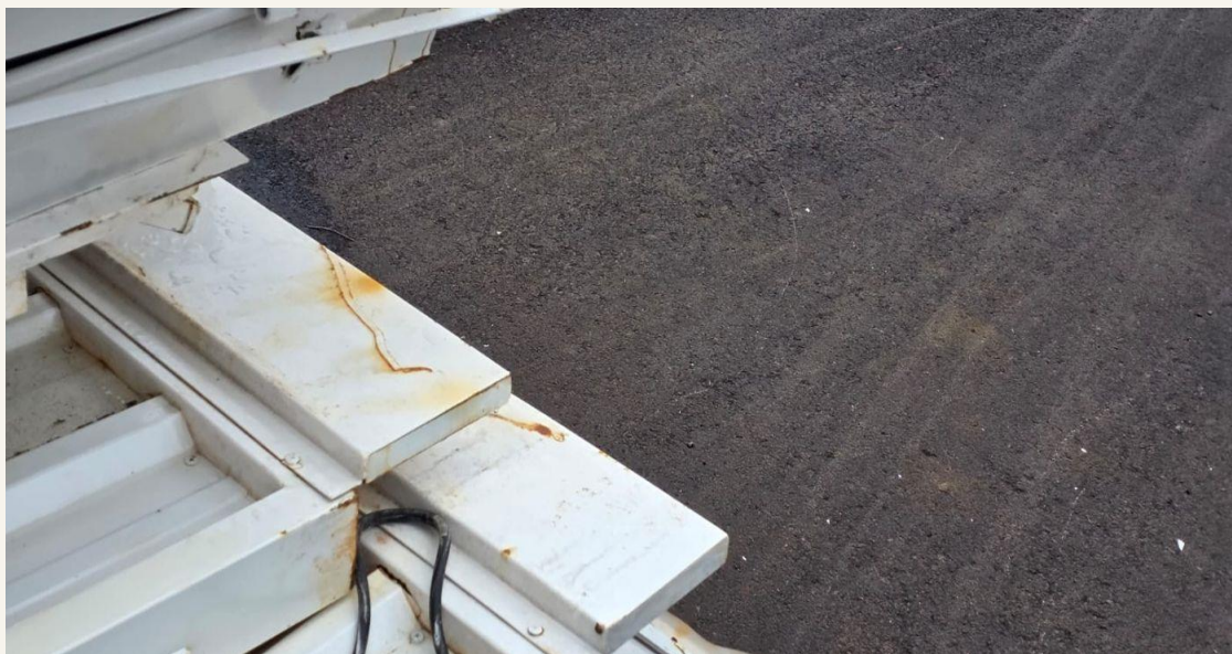
Fotografia 44 — Extremidade de perfil tubular rompida, com oxidação na superfície de fratura.
