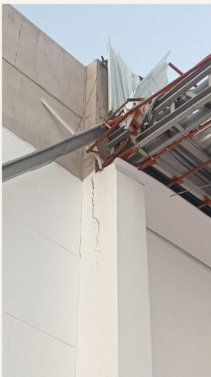
Fotografia 04 — Fissura vertical na cabeça de pilar, logo abaixo do apoio da cobertura. Registro recebido da contratante em 30/09/2026.
