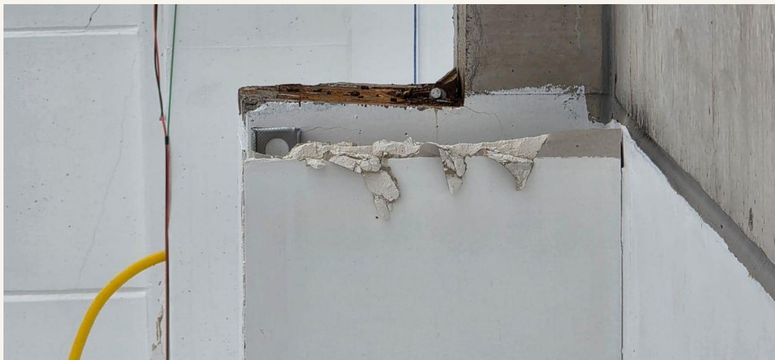
Fotografia 46 — Nicho no topo de placa, com inserto metálico embutido e peça de madeira deteriorada.
