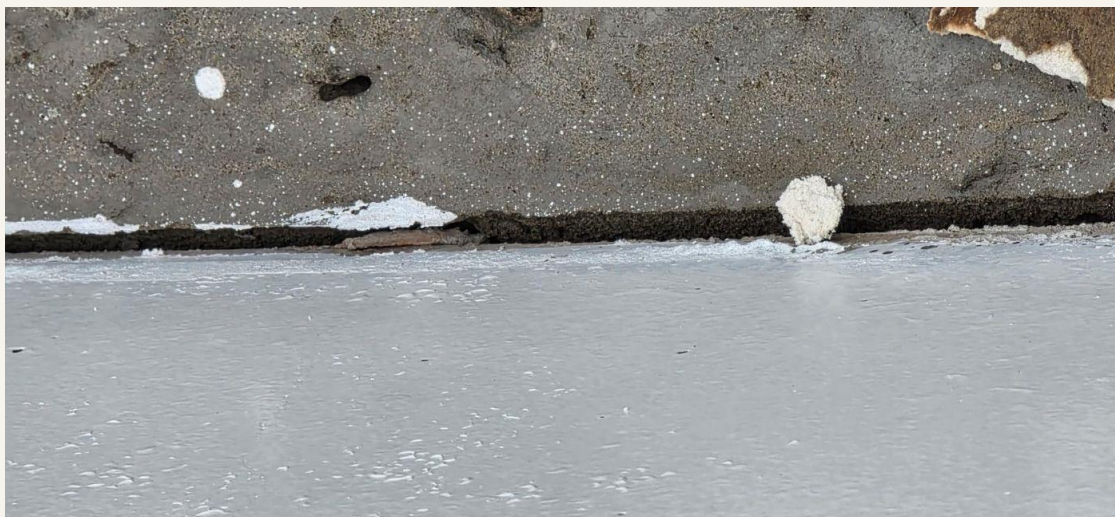
Fotografia 38 — Junta entre o concreto aparente e peça metálica, com fragmentos soltos.
