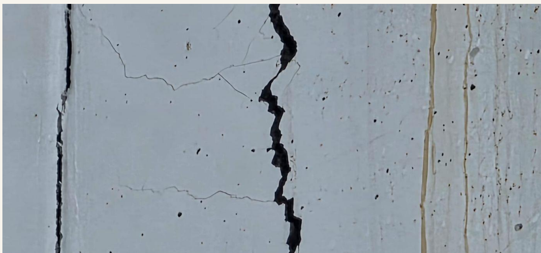
Fotografia 84 — Primeiro pilar junto ao portão: fenda vertical larga, em zigue-zague, na face do pilar, com fissuras finas horizontais e a junta com a placa vizinha aberta.
