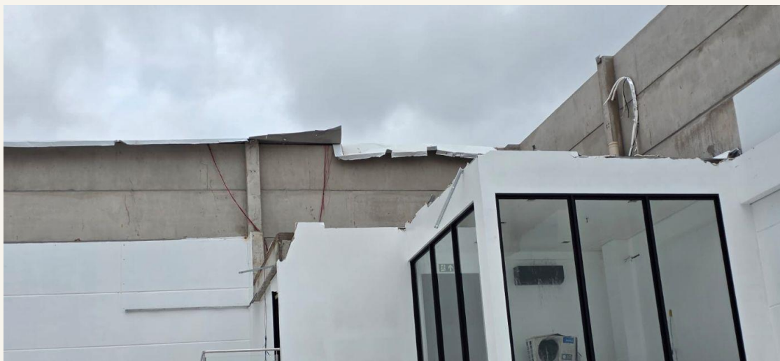
Fotografia 36 — Interior do hangar, enquadramento mais amplo: bloco de escritórios íntegro sob a cobertura ausente.
