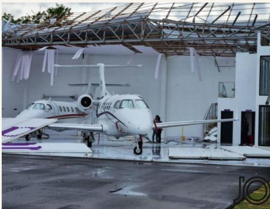
Fotografia 70 — Fachada do portão no dia seguinte: folhas do portão caídas no piso, junto ao vão, uma delas sobre a ponta da asa da aeronave dianteira; estrutura frontal da cobertura deformada e sem telhas; faixas de forro pendentes.
