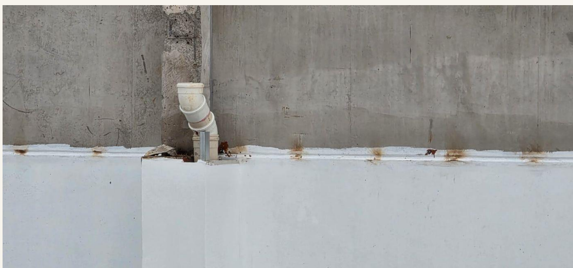
Fotografia 33 — Condutor pluvial e respectivo suporte no topo do fechamento, ainda fixados.
