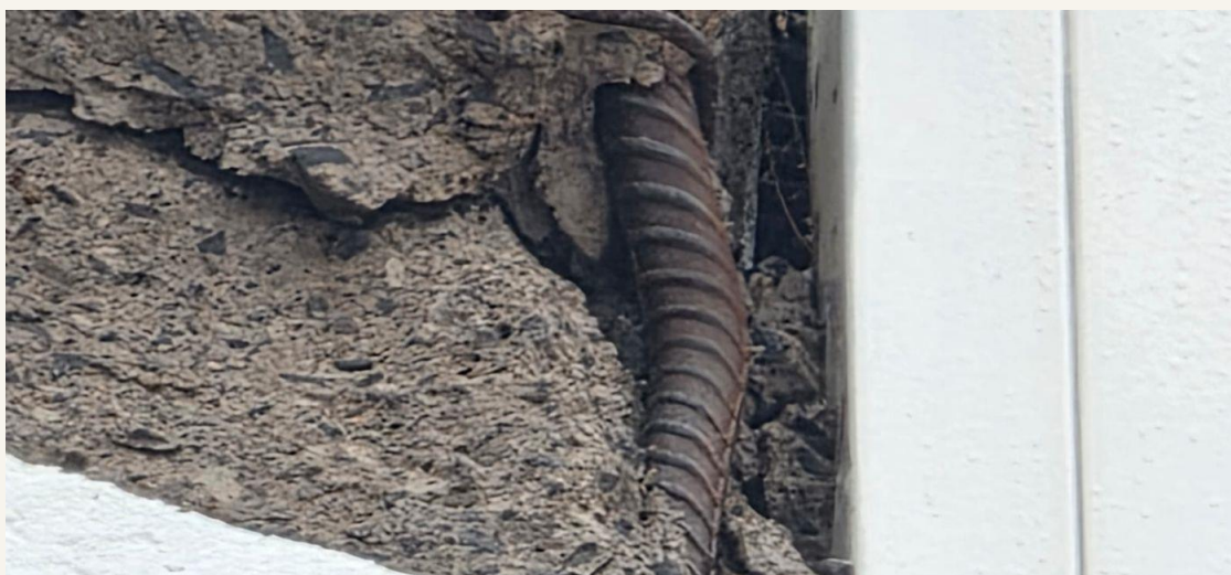
Fotografia 86 — Aproximação da Fotografia 85: barra longitudinal curvada para fora, concreto fraturado com agregado gráúdo exposto e fissura atravessando a seção.
