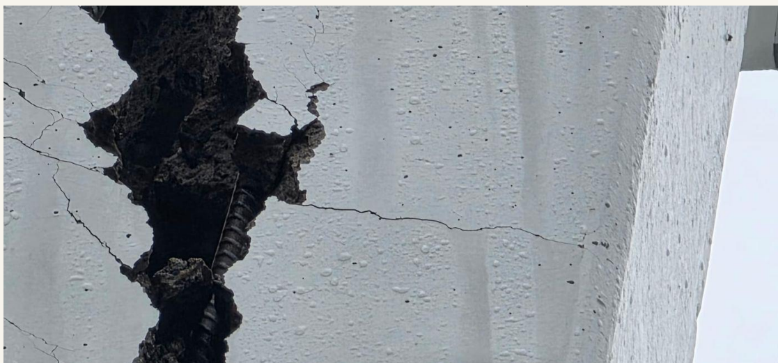
Fotografia 92 — Mesmo pilar, com a quina chanfrada à direita: a abertura acompanha a barra e uma fissura horizontal corta a face até a quina.
