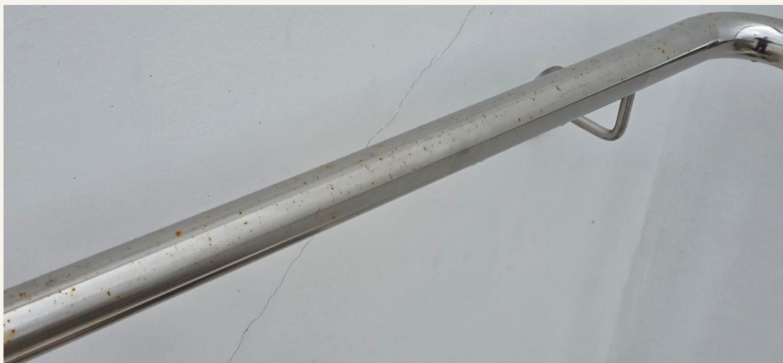
Fotografia 56 — Outro trecho do corrimão, com a fissura capilar prosseguindo.
