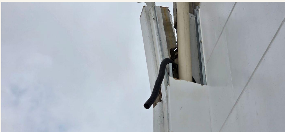
Fotografia 52 — O mesmo trecho da Fotografia 51, com o concreto fraturado visível atrás do painel.
