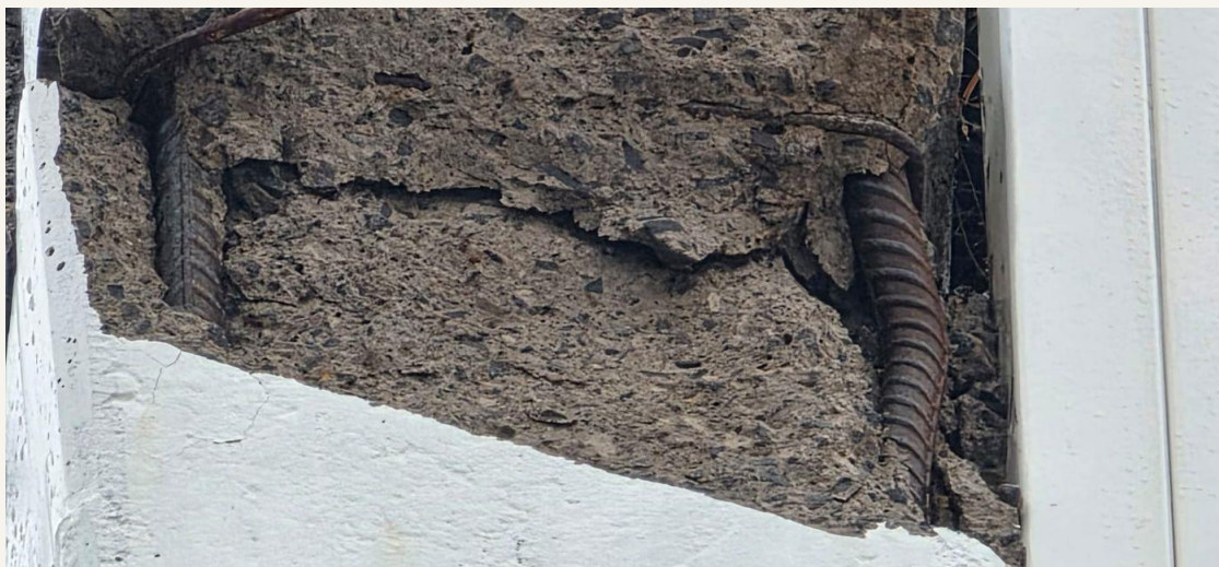
Fotografia 85 — Primeiro pilar junto ao portão: o topo destacou-se em cunha, expondo duas barras longitudinais nervuradas e um estribo, junto ao perfil branco do fechamento da fachada.
