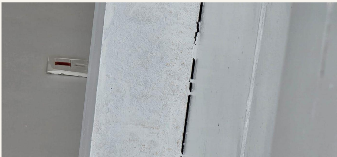
Fotografia 47 — Fissura vertical no encontro entre painéis, no bloco de escritórios.
