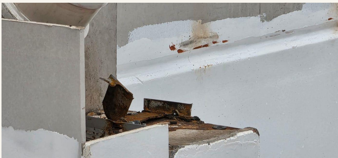
Fotografia 21 — Mesmo topo de pilar da Fotografia 20, em outro ângulo.
