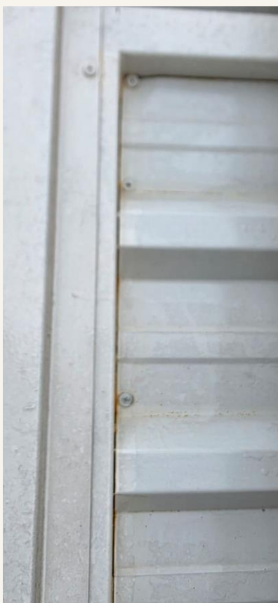
Fotografia 80 — Detalhe do quadro de uma folha: chapa trapezoidal fixada ao montante por parafusos autobrocantes, sem rasgamento neste trecho.
