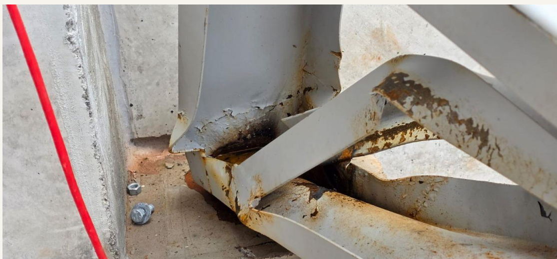
Fotografia 18 — Parafuso com arruela e porca soltos sobre a superfície de concreto, ao lado da ligação rompida.
