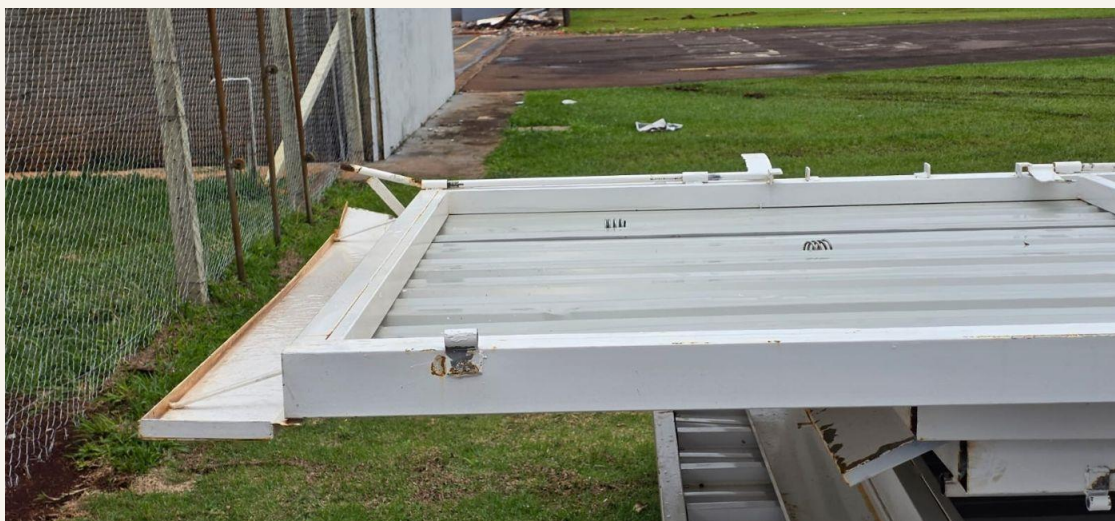
Fotografia 39 — Folha completa do portão caída sobre o gramado, com os ganchos de suspensão na borda superior.
