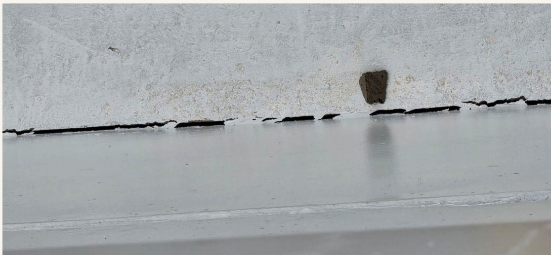
Fotografia 48 — Junta horizontal aberta entre elemento de concreto e peça metálica.
