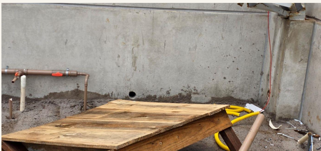
Fotografia 37 — Piso interno com tubulação hidráulica aparente, detritos e acúmulo de material fino.
