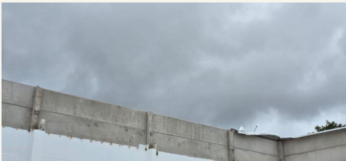
Fotografia 11 — Platibanda contra o céu, com a cobertura ausente.
