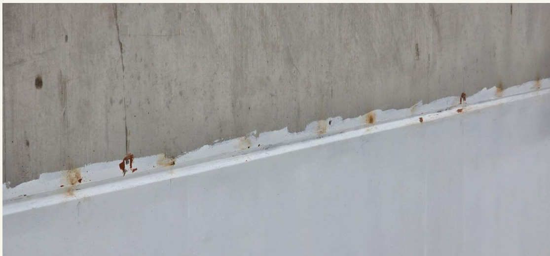
Fotografia 30 — Linha de pontos de fixação arrancados no topo da placa pintada, junto à junta com a platibanda.
