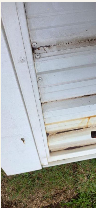
Fotografia 81 — Montante e chapa de folha do portão, com escorrimentos de oxidação nas ondas e pontos de fixação íntegros.
