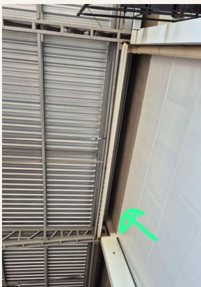
Fotografia 69 — Encontro entre a borda da cobertura e o topo do fechamento lateral, com seta de terceiro sobre a junta.
