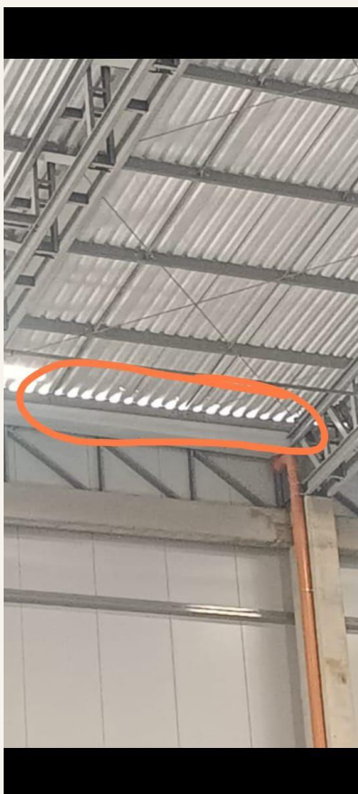
Fotografia 67 — Detalhe da borda da cobertura sobre a parede lateral, com contorno laranja de terceiro sobre as ondas abertas da telha.
