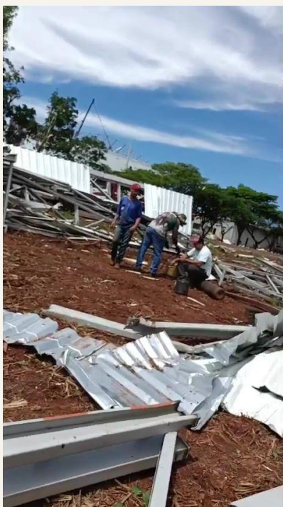
Fotografia 105 — Equipe de corte junto aos destroços; terças, telhas galvanizadas e brancas amassadas em primeiro plano.
