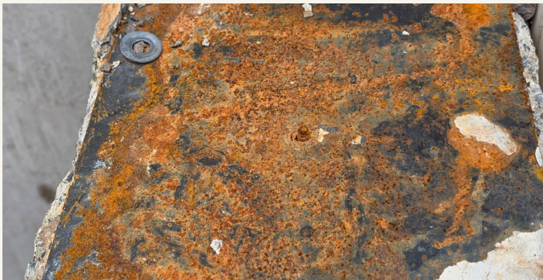
Fotografia 22 — Chapa de ligação embutida no concreto, com corrosão generalizada na face exposta.
