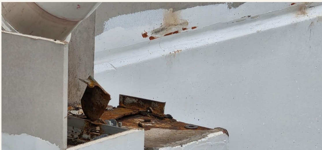
Fotografia 20 — Topo de pilar após a ruína: chapa embutida com produto de oxidação, arruela em furo vazio, chapa rasgada e cantoneira deformada.
