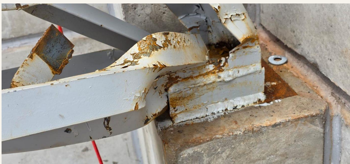
Fotografia 19 — Nó de extremidade da treliça sobre o consolo de concreto, com arruela solta em furo vazio.
