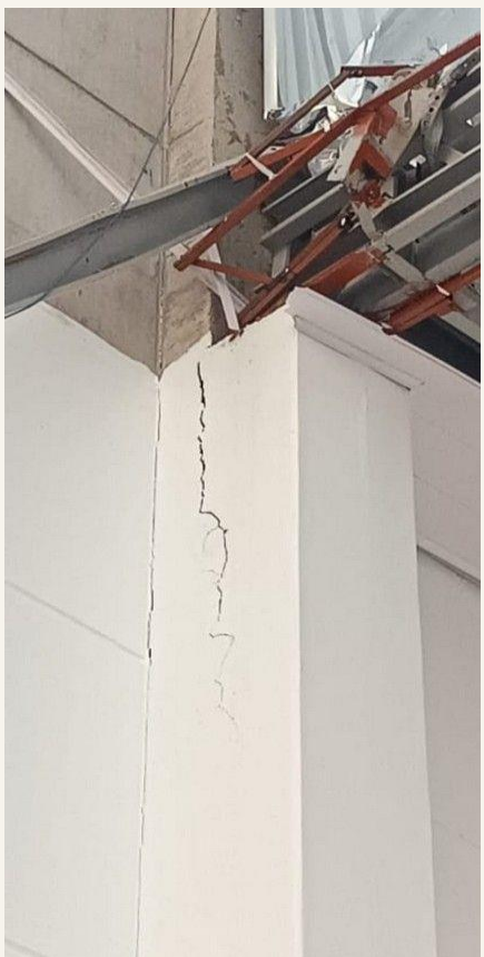
Fotografia 05 — Aproximação da mesma fissura da Fotografia 04. Registro recebido da contratante em 30/09/2026.
