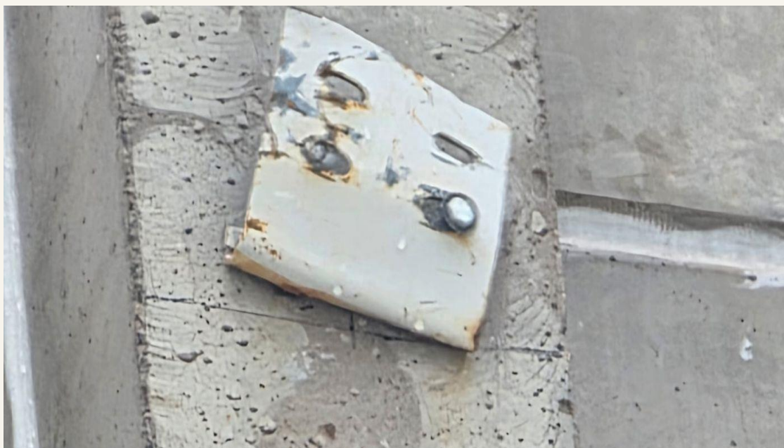
Fotografia 98 — Outra chapa de ligação no topo de pilar, dobrada, com dois furos alongados e dois fixadores remanescentes de cabeça arredondada, sobre concreto com marcas de desgaste.
