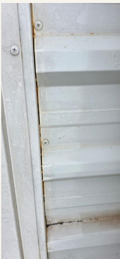
Fotografia 82 — Junção entre montante e chapa, com fresta aberta ao longo da borda e um ponto de oxidação junto a parafuso.
